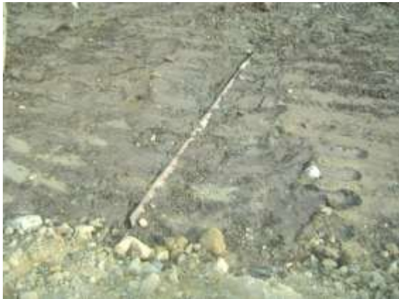
Trabajos de pavimentación de pistas que destruyen tuberías
