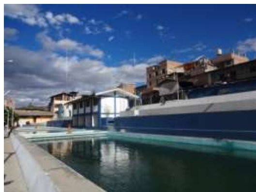
Vistas de Planta de Tratamiento de Agua Santa Apolonia
