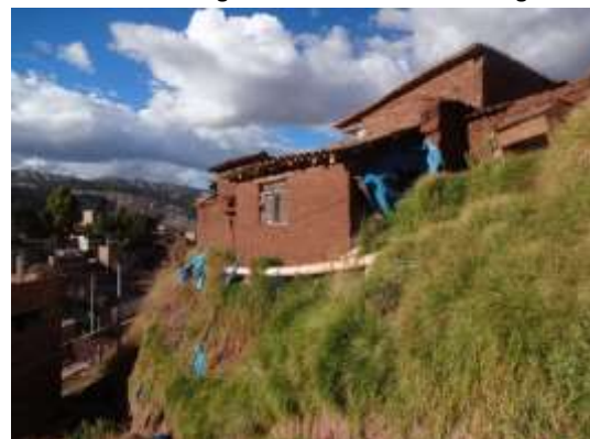
Estado de algunas redes de desagüe en Santiago
