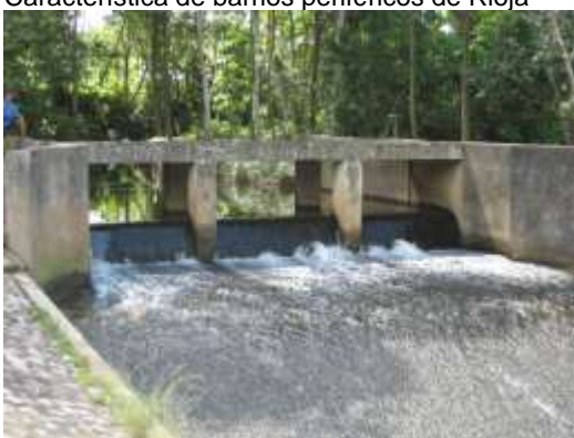
Captación de agua del río Uquihua
