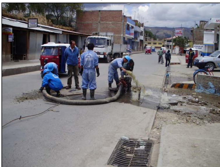
Foto 2.4.7: Atención a emergencia – atoro de red de alcantarillado
