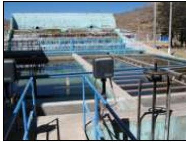
1-2. Planta de tratamiento de agua potable Aziruni (módulo I)
