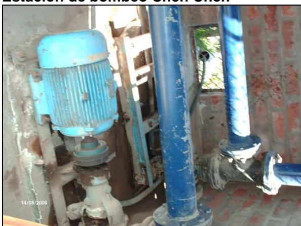
Gráfico N° 1.5 Estación de bombeo Chen Chen
