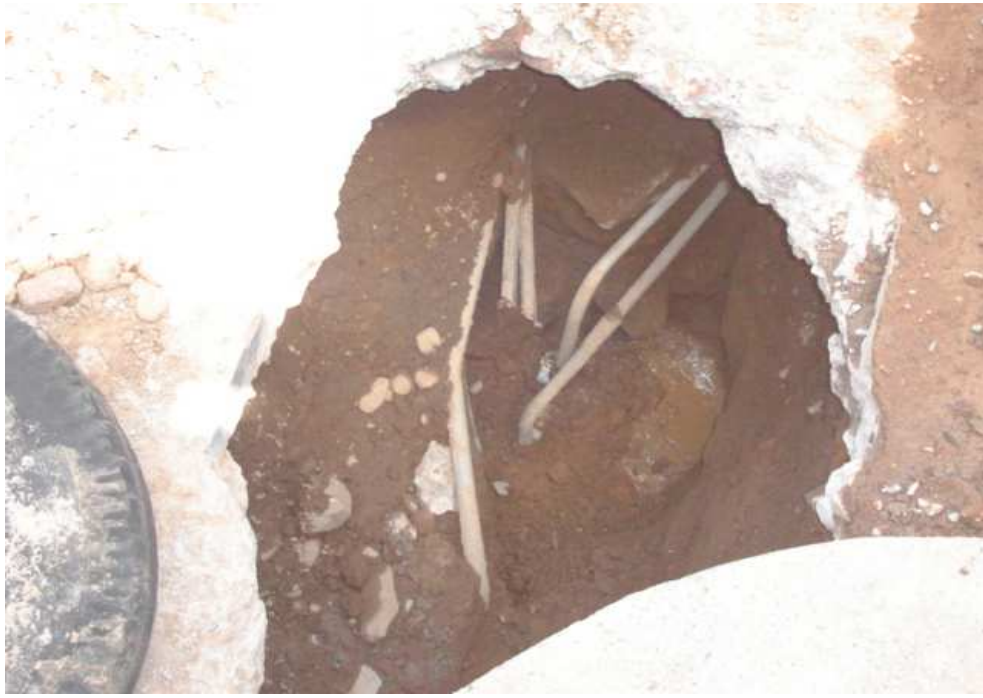
7ª cuadra del Jr. Libertad con fuga de agua potable, reparando la Eps.
